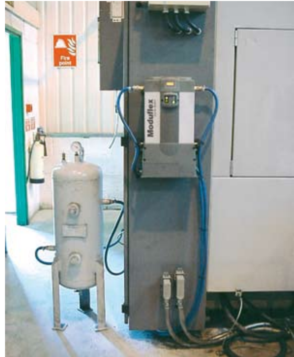
Sistema de Aire Seco Moduflex instalado para suministrar aire de control para un centro de máquinas CNC
